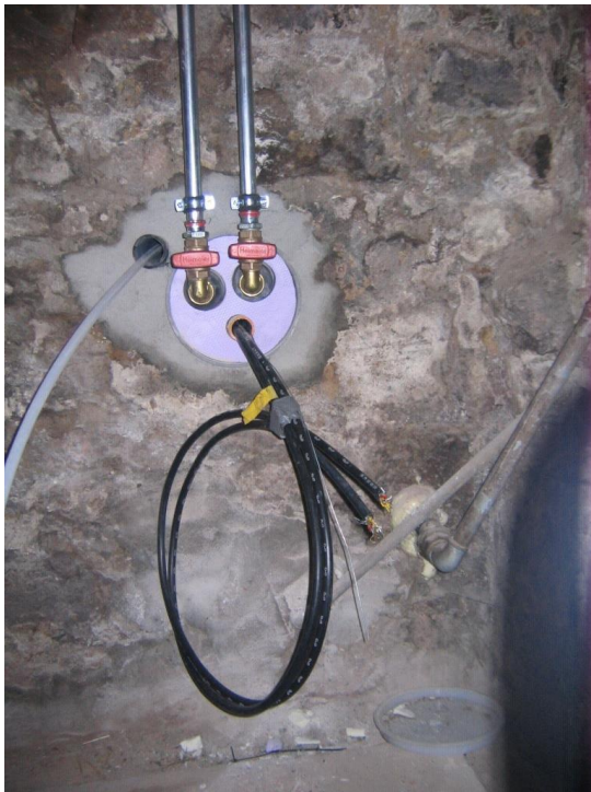
Hauseinführung mit Absperrinrichtung
