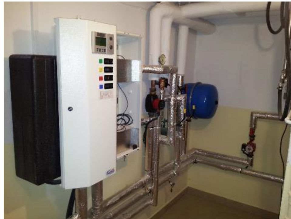
Übergabestation mit Leistung für das Ein-, Zwei- und Mehrfamilienhaus
