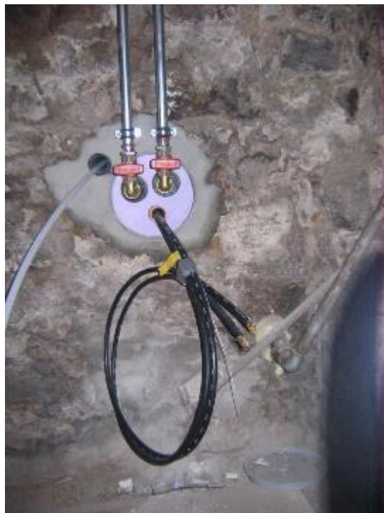
Hauseinführung mit Absperrinrichtung
